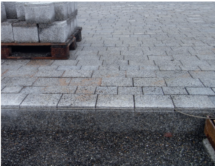
Abbildung 9: Der Lapis Perfectus wird üblicher Weise in ungebundener Bauweise auf ein Bett mit Hartgesteinsplitt 2/5 oder Bettungsmaterial gesetzt
