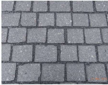
Abbildung 4: ... während ein Großpflasterstein mit großer Fuge sehr leicht aus dem Verbund herausgelöst werden kann
