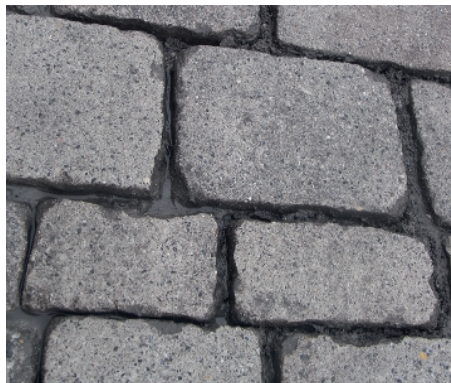
Abbildung 7: ... kann das Fugenmaterial nicht langfristig halten
